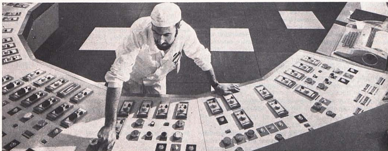
Centrale de Bugey : salle des commandes. Imaginer toutes les défaillances éventuelles.
